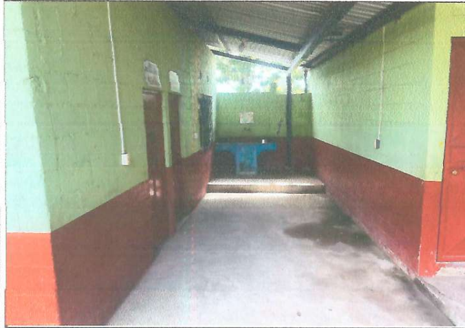
Foto 1: Mejoramiento de cocina: Puerta, ventana, pila, piso, iluminación, gabinetes, mesa y azulejo.
